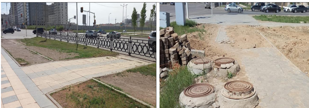
Тротуар без функциональной необходимости Канализационные люки на пешеходном тротуаре
