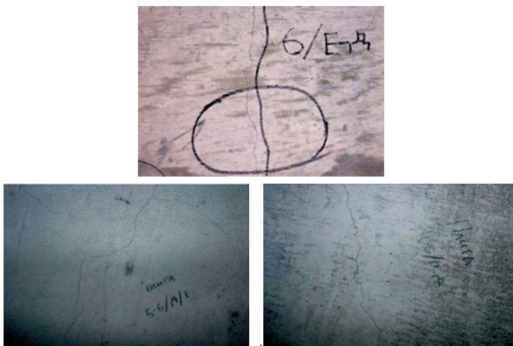
Рисунок 3. Трещины в плите перекрытия верхнего уровня подземного здания
