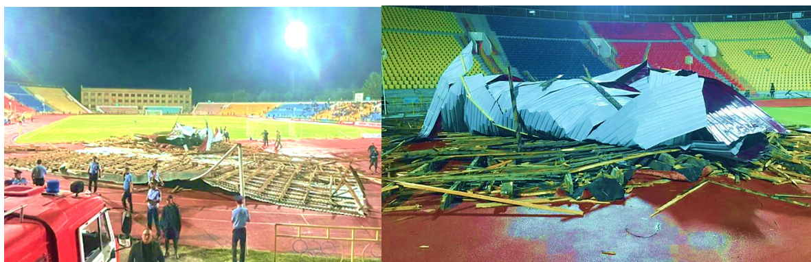
Рисунок 1. Обрушение крыши здания Центрального стадиона, г.Шымкент
